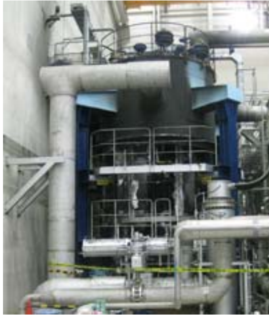
図4 火災を起こしたコールドボックスの近景。外筒に黒いススが付いているのが確認できます。
