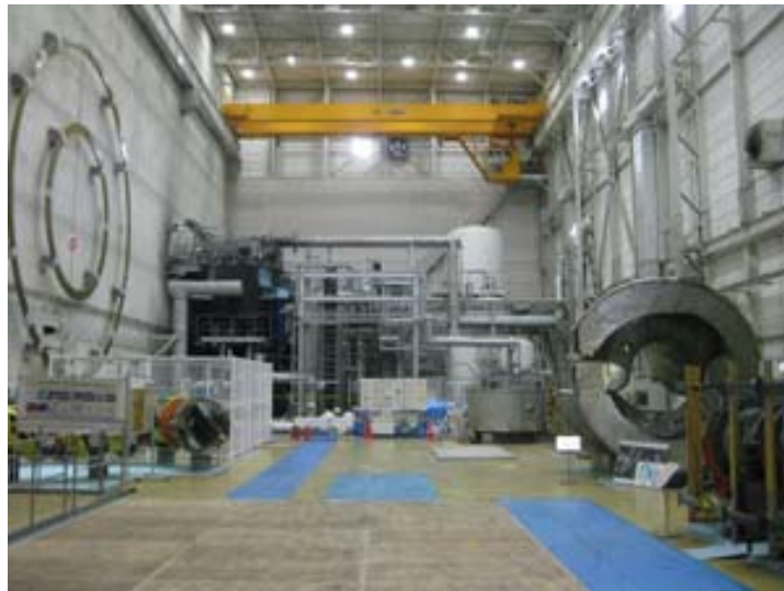
図3 火災後のヘリウム液化冷凍機室。左奥の黒くなった部分(一部、元の塗装色である水色が残っています)が火災を起こしたコールドボックス。火災は局所的で、コールドボックス以外の機器や建物には被害はありませんでした。(手前は展示用スペース)
